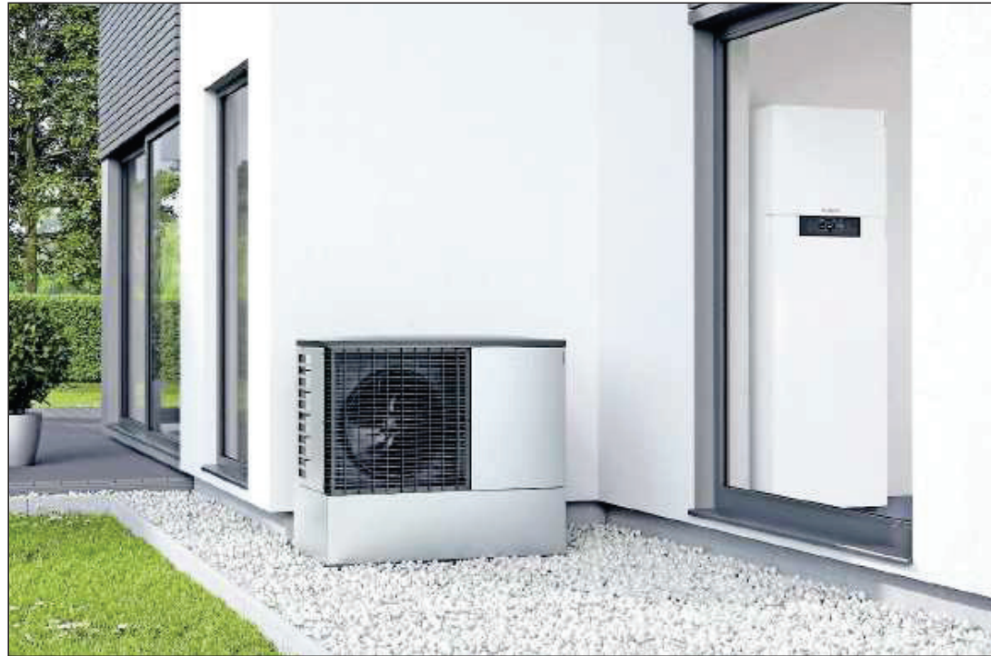
Wärmepumpen sind nahezu wartungsfrei.
